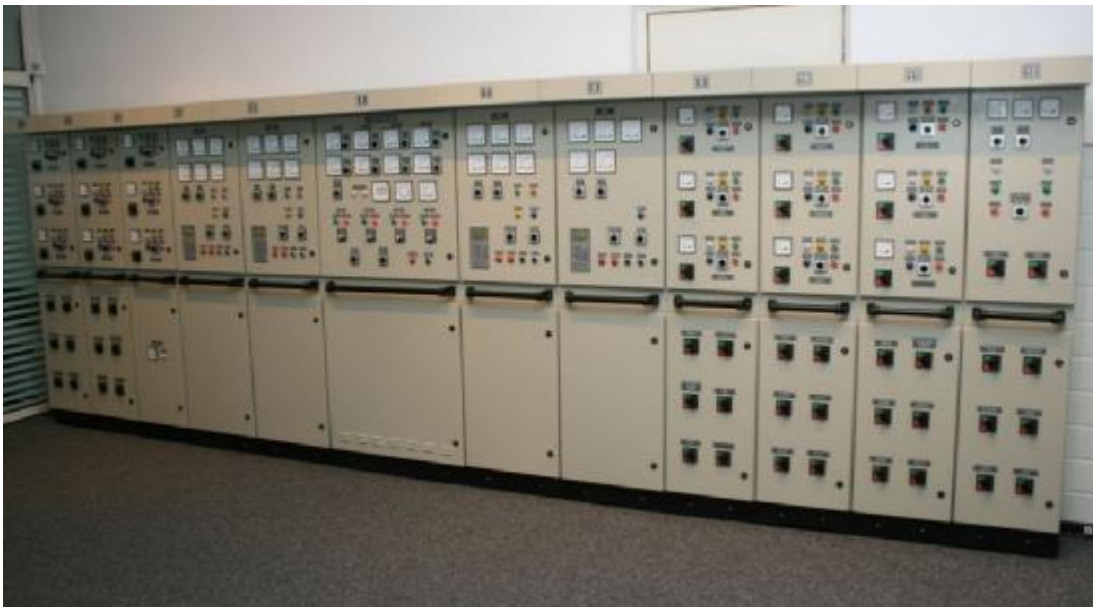
Fig. 5. MED3Dh - Główna tablica rozdzielcza energii elektrycznej.
